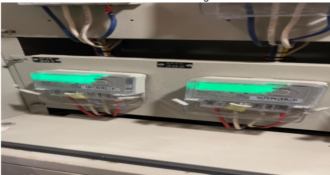
Contador de Energia
