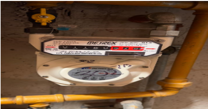
Contador de Gas
