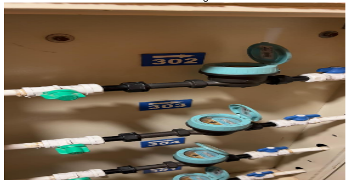
Contador de Agua
