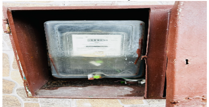
Contador de Energia
