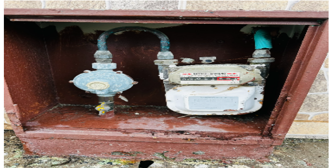
Contador de Gas
