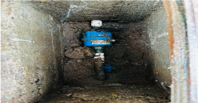
Contador de Agua
