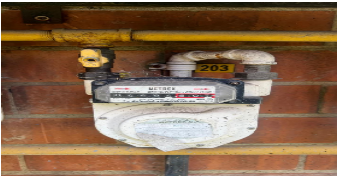
Contador de Gas
