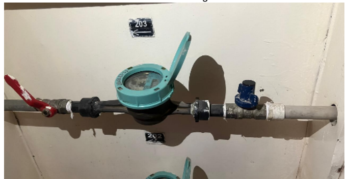
Contador de Agua
