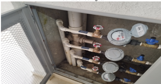
Contador de Agua
