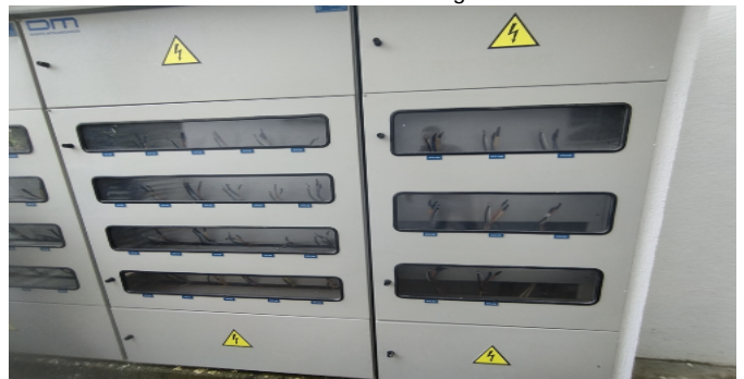
Contador de Energia
