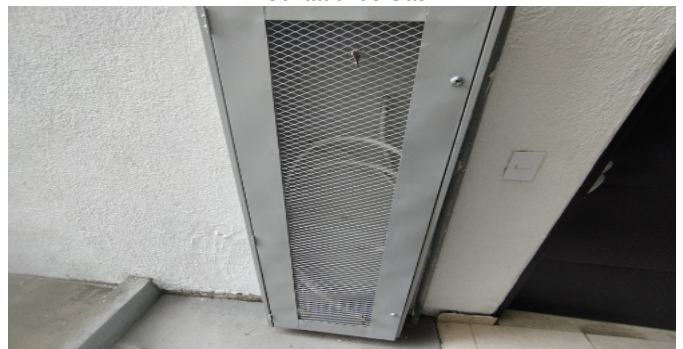
Contador de Gas
