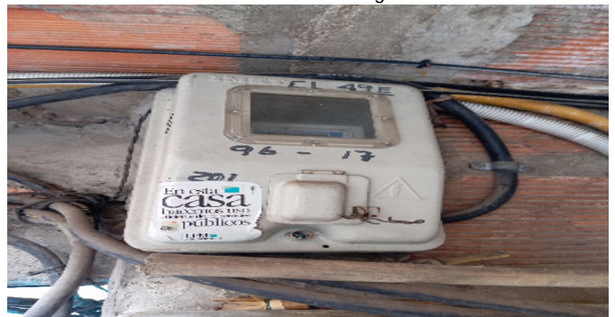
Contador de Energia
