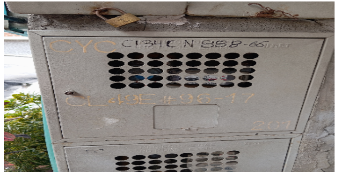
Contador de Gas
