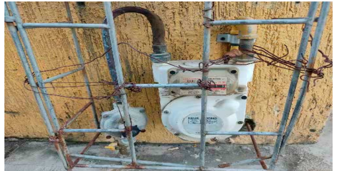
Contador de Gas
