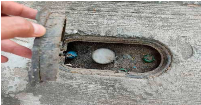
Contador de Agua
