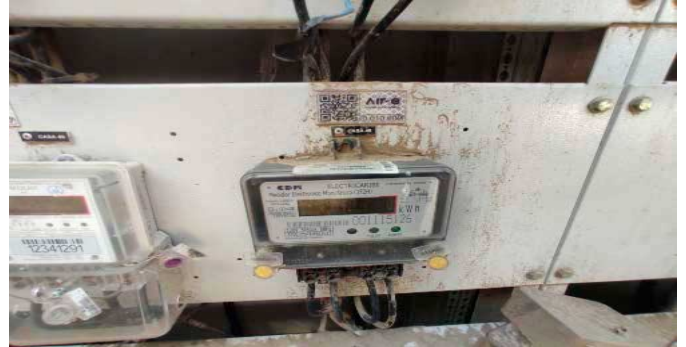
Contador de Energia
