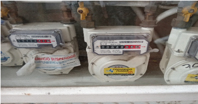
Contador de Gas
