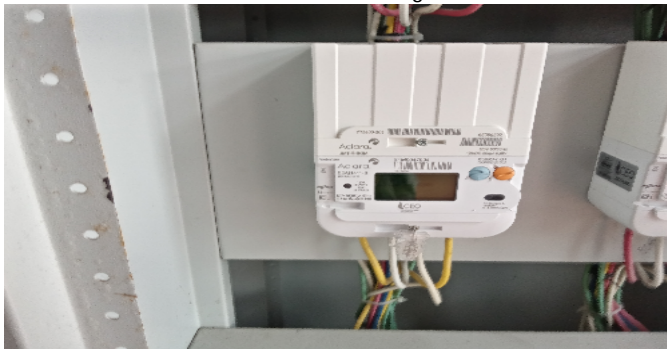
Contador de Energia
