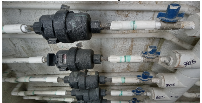
Contador de Agua
