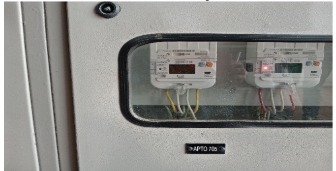
Contador de Energia
