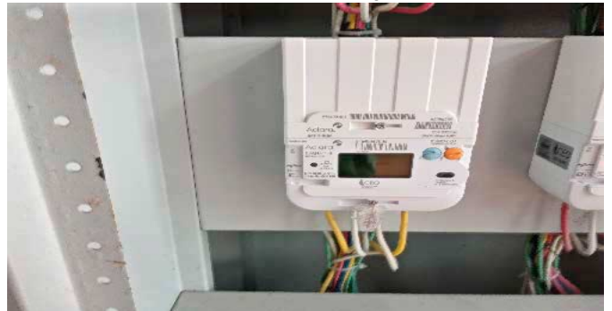
Contador de Energia
