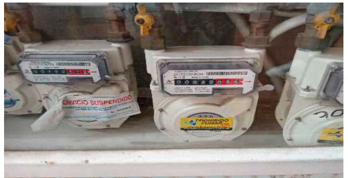
Contador de Gas
