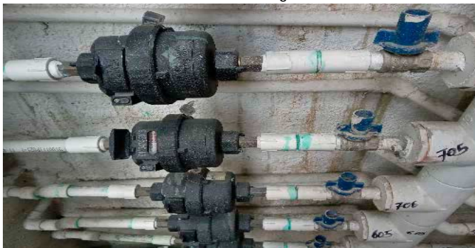
Contador de Agua
