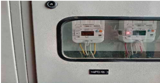
Contador de Energia
