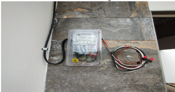
Contador de Energia
