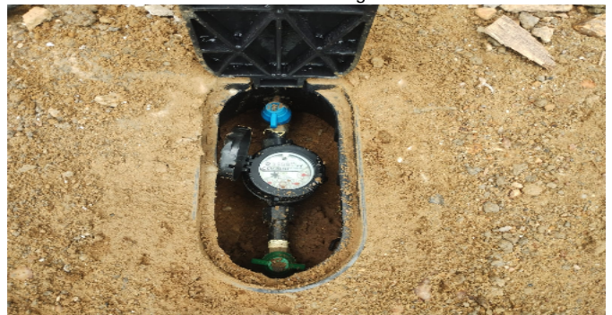
Contador de Agua
