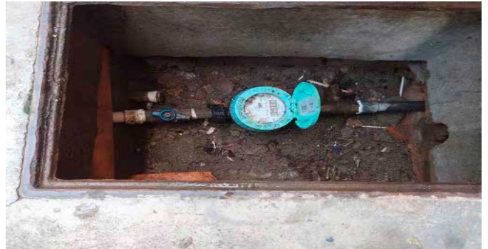
Contador de Agua
