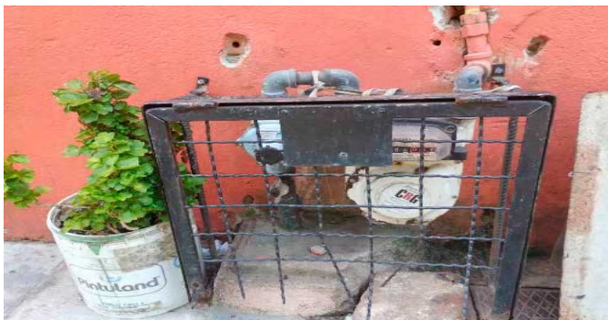
Contador de Gas
