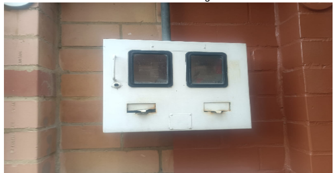
Contador de Energia
