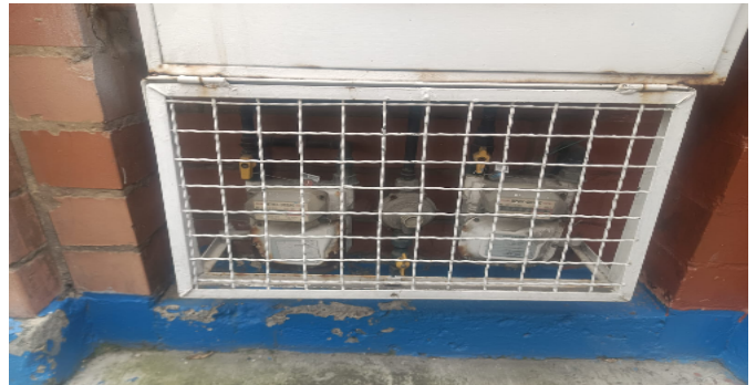
Contador de Gas
