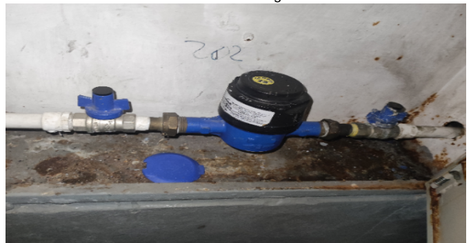
Contador de Agua
