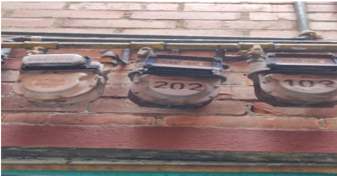
Contador de Gas
