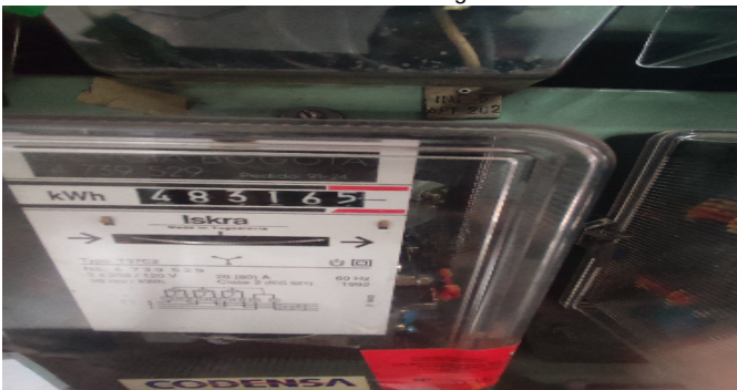
Contador de Energia
