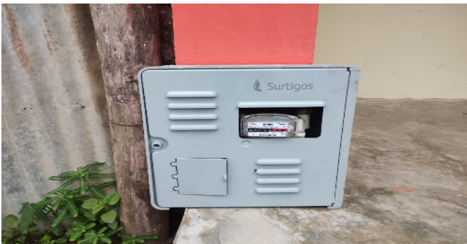
Contador de Gas
