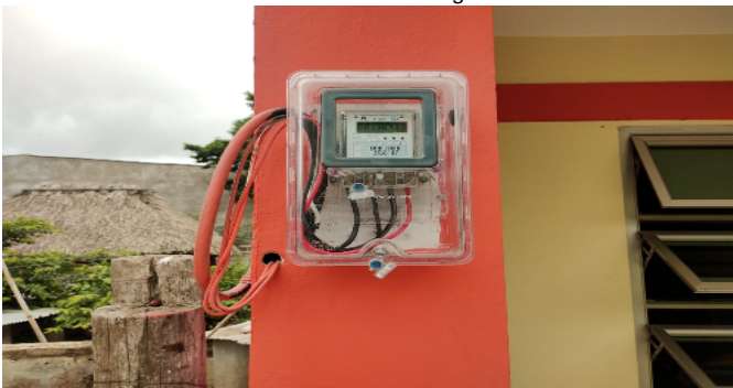
Contador de Energia
