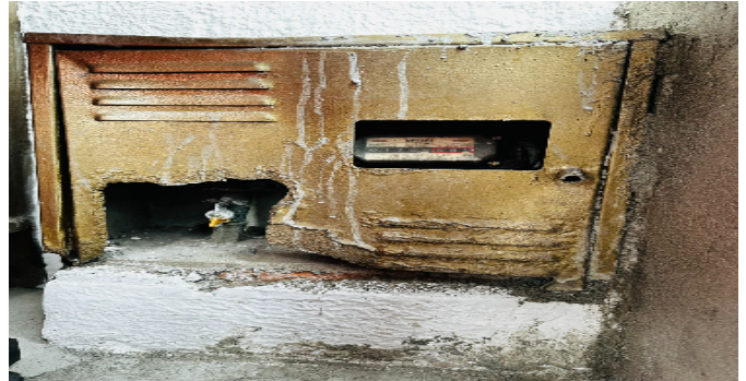
Contador de Gas
