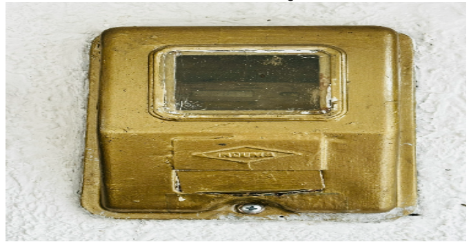
Contador de Energia
