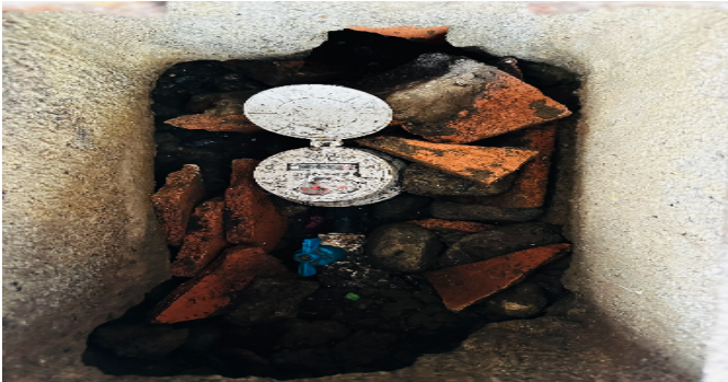
Contador de Agua
