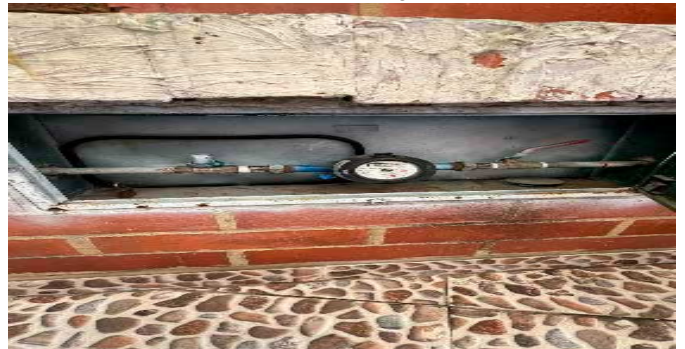
Contador de Agua
