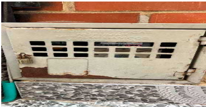
Contador de Gas
