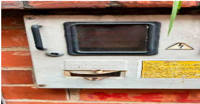
Contador de Energia
