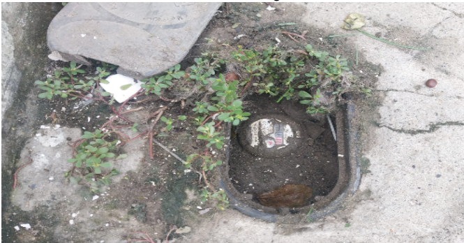
Contador de Agua
