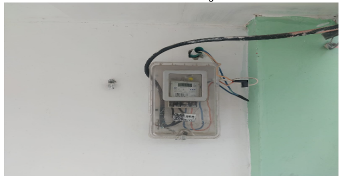
Contador de Energia
