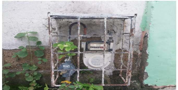
Contador de Gas
