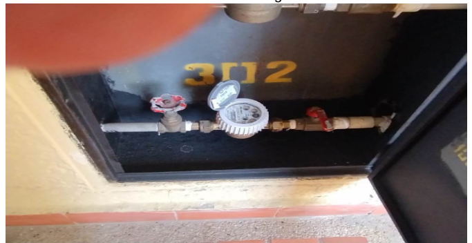
Contador de Agua
