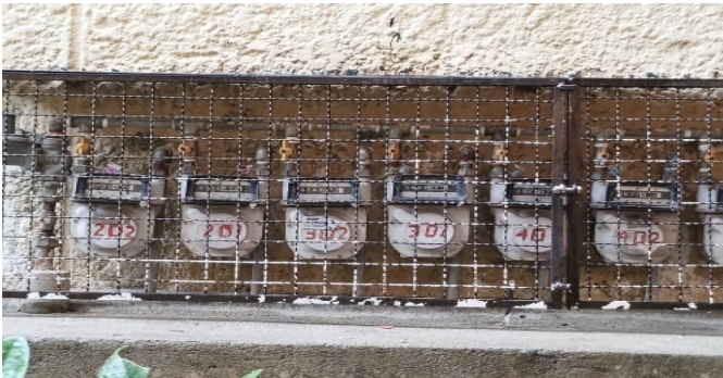
Contador de Gas
