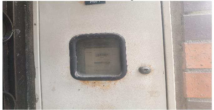
Contador de Energia
