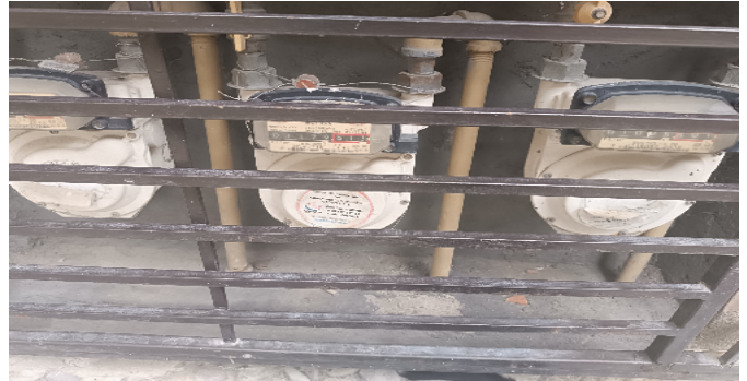
Contador de Gas
