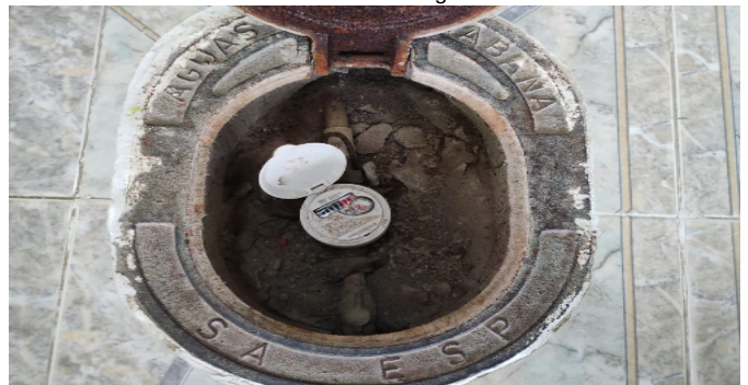
Contador de Agua
