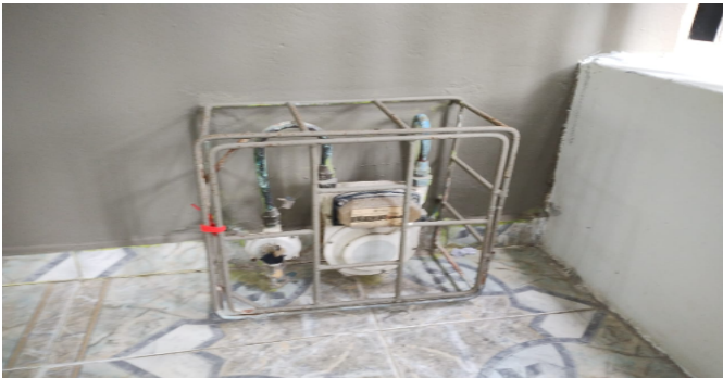
Contador de Gas
