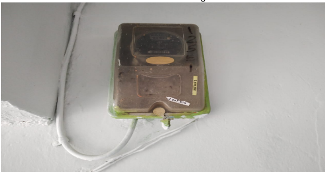
Contador de Energia
