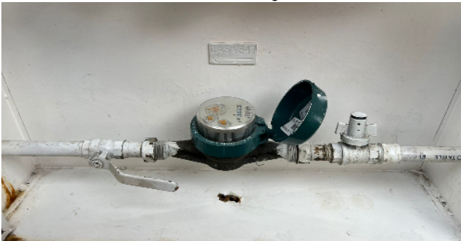
Contador de Agua
