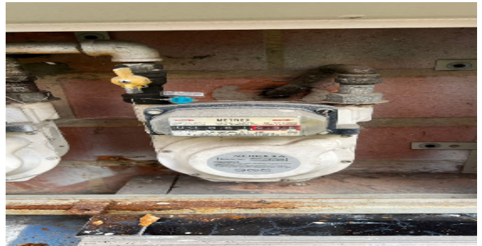
Contador de Gas
