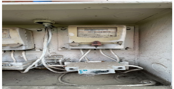
Contador de Energia
