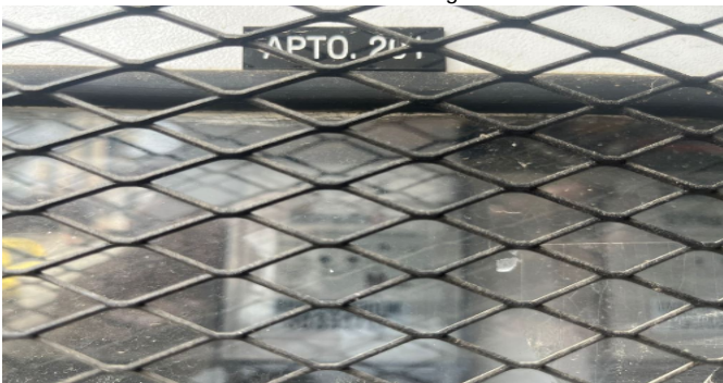
Contador de Energia
