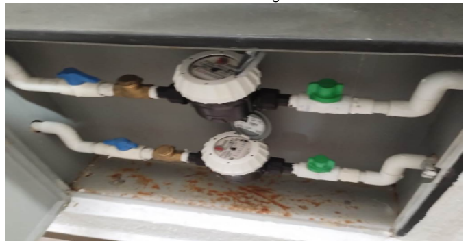
Contador de Agua
