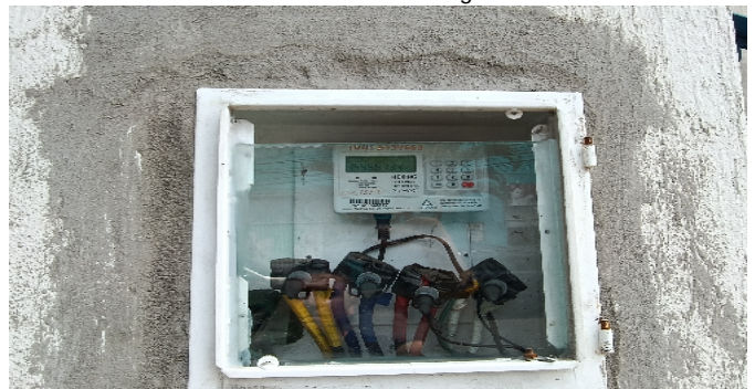
Contador de Energia
