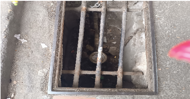
Contador de Agua
