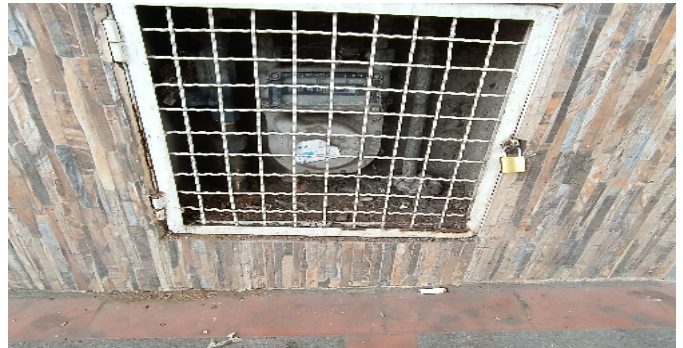
Contador de Gas
