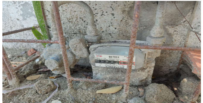
Contador de Gas
