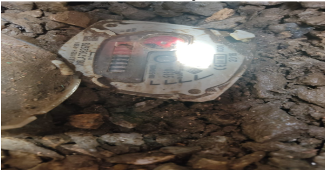
Contador de Agua
