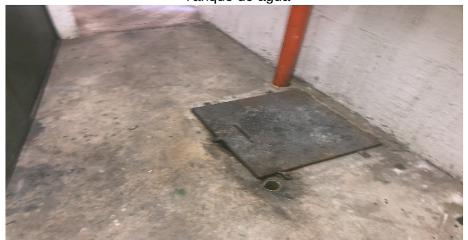
Tanque de agua
