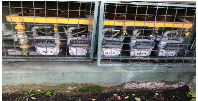
Contador de Gas
