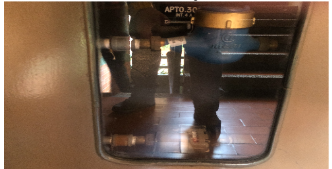
Contador de Agua
