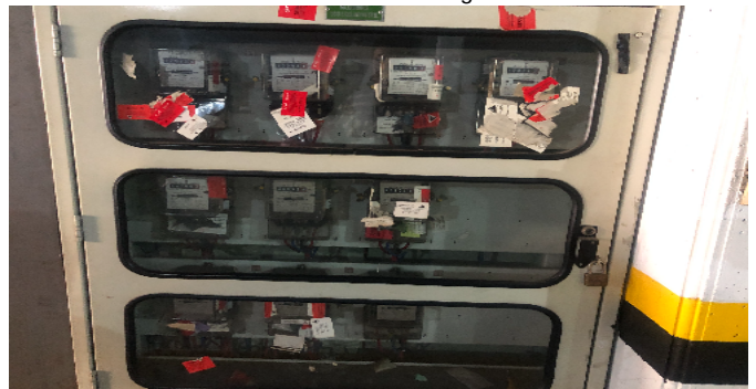
Contador de Energia
