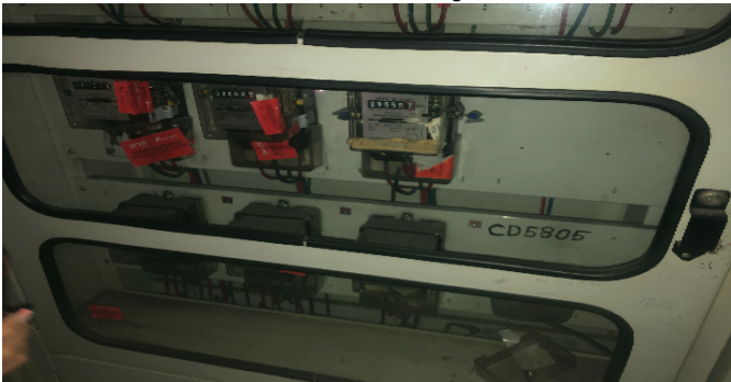
Contador de Energia
