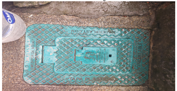
Contador de Agua
