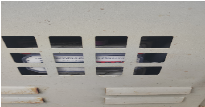
Contador de Gas
