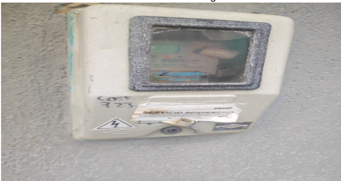
Contador de Energia
