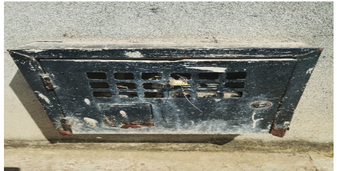
Contador de Gas
