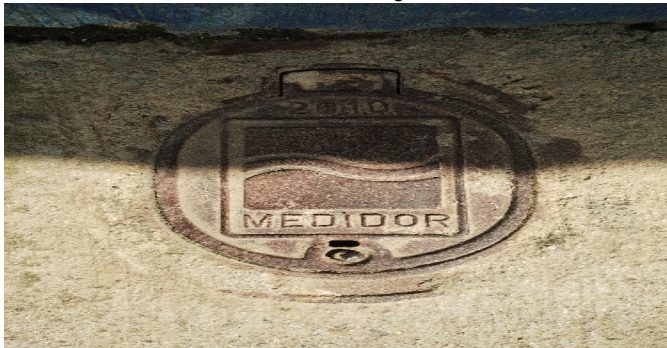
Contador de Agua
