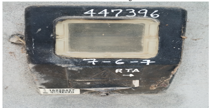
Contador de Energia
