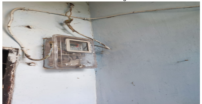
Contador de Energia
