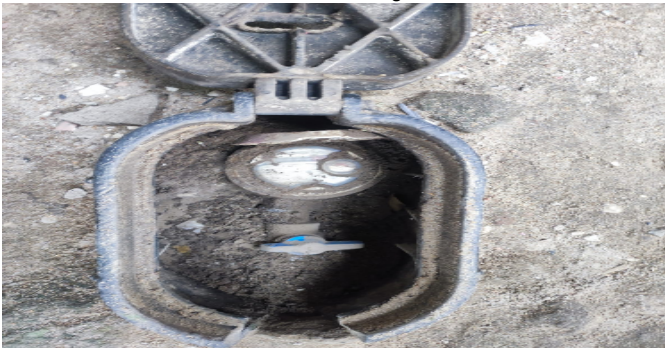
Contador de Agua
