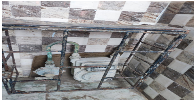
Contador de Gas
