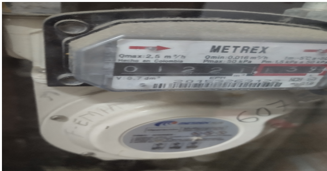
Contador de Gas
