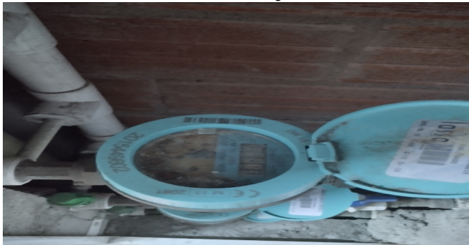
Contador de Agua
