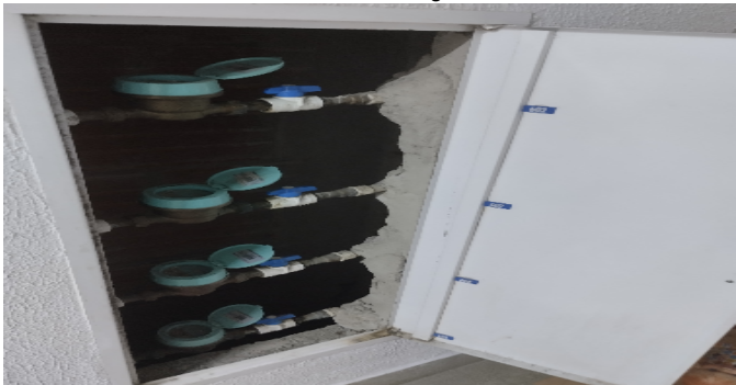
Contador de Agua
