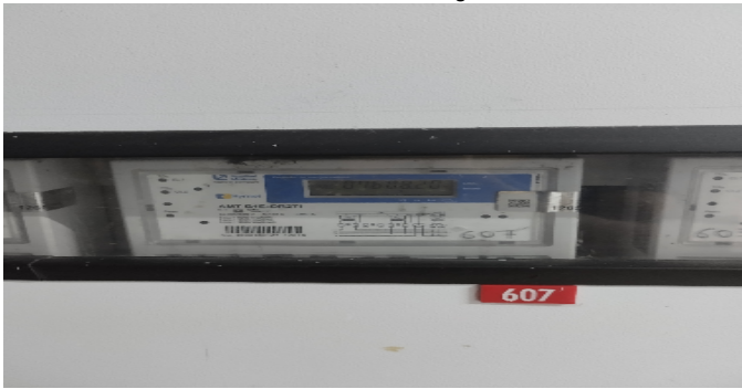
Contador de Energia
