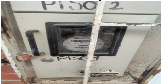
Contador de Energia
