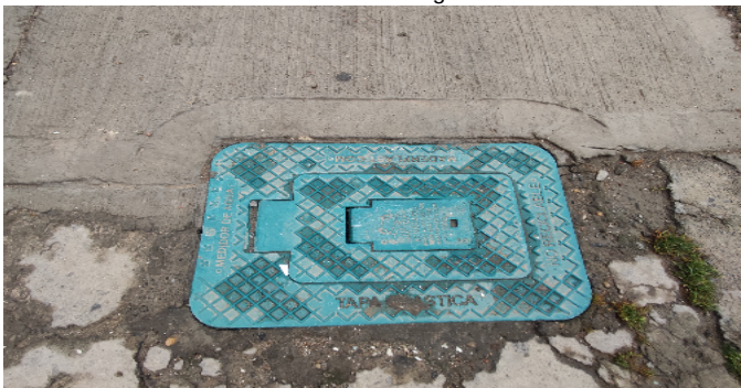
Contador de Agua
