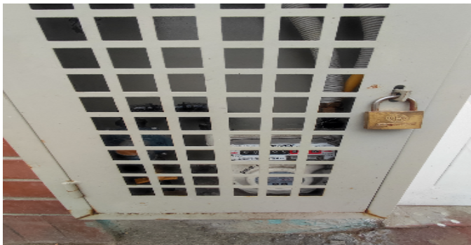
Contador de Gas
