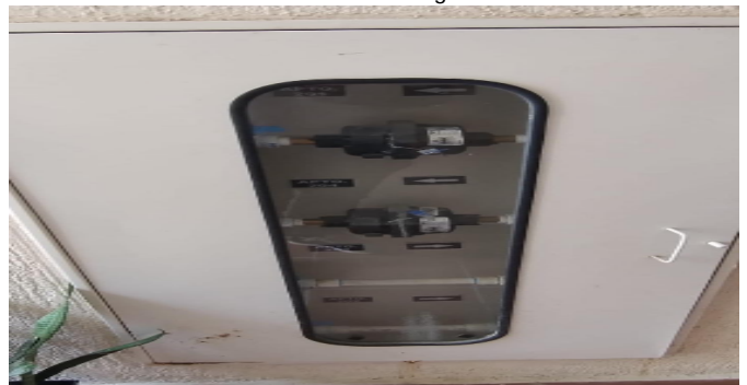
Contador de Agua
