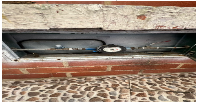
Contador de Agua
