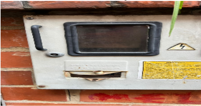
Contador de Energia
