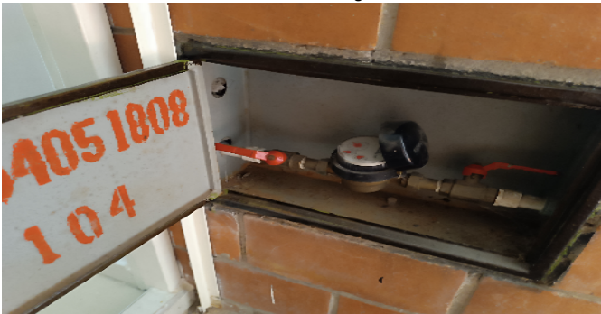
Contador de Agua
