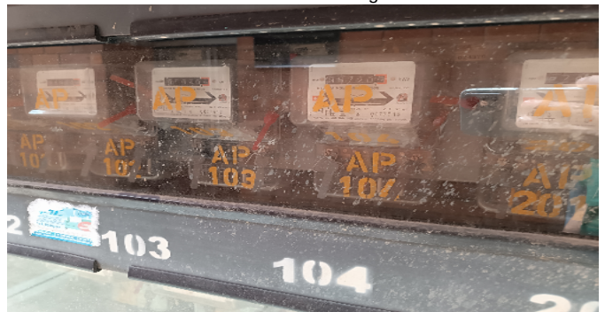
Contador de Energia
