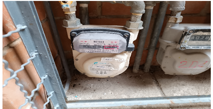
Contador de Gas
