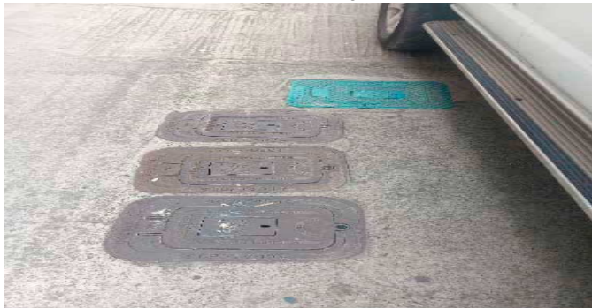
Contador de Agua
