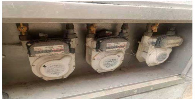
Contador de Gas
