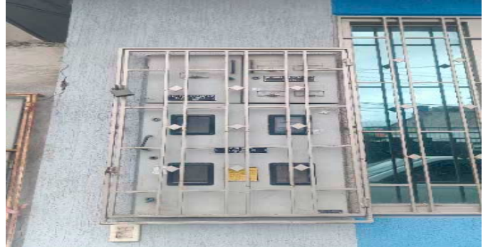
Contador de Energia
