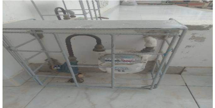
Contador de Gas
