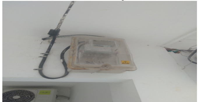
Contador de Energia
