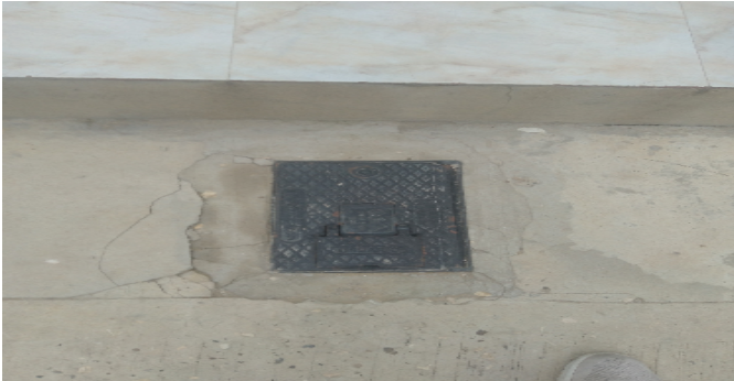
Contador de Agua
