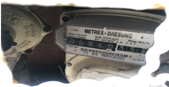
Contador de Gas
