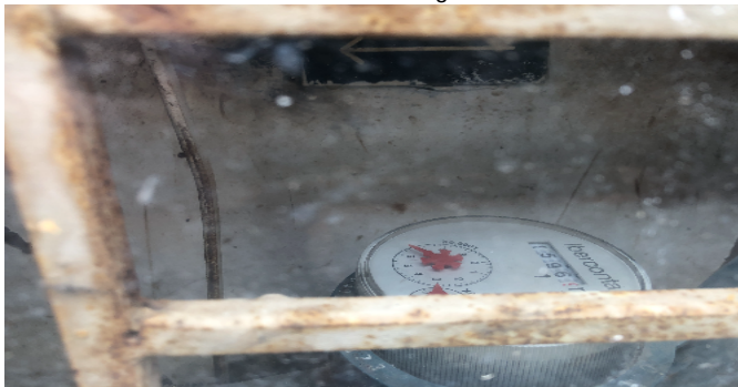
Contador de Agua
