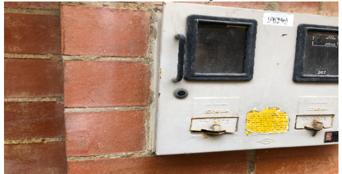
Contador de Energia
