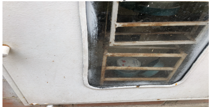
Contador de Agua
