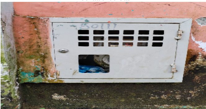
Contador de Gas
