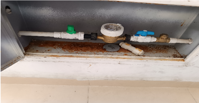
Contador de Agua
