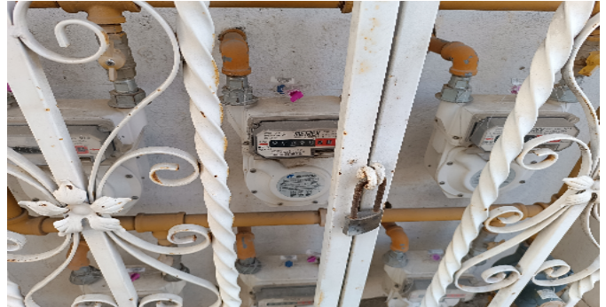
Contador de Gas
