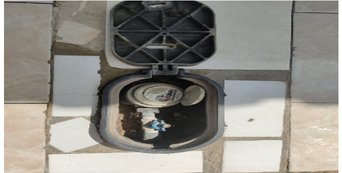
Contador de Agua
