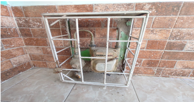
Contador de Gas
