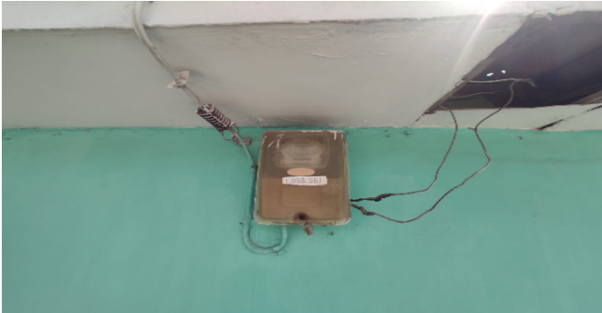
Contador de Energia
