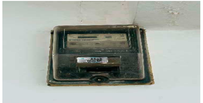
Contador de Energia
