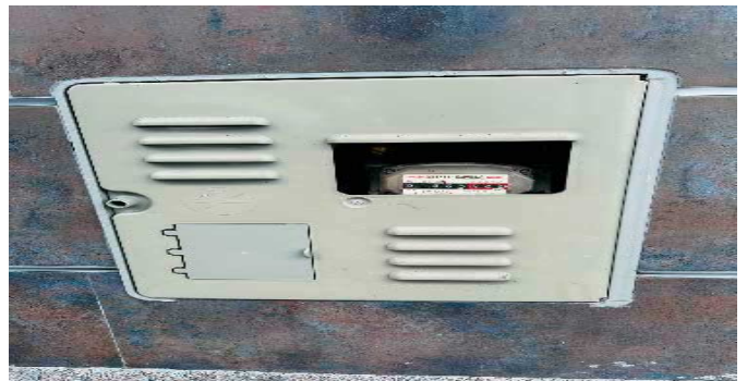
Contador de Gas
