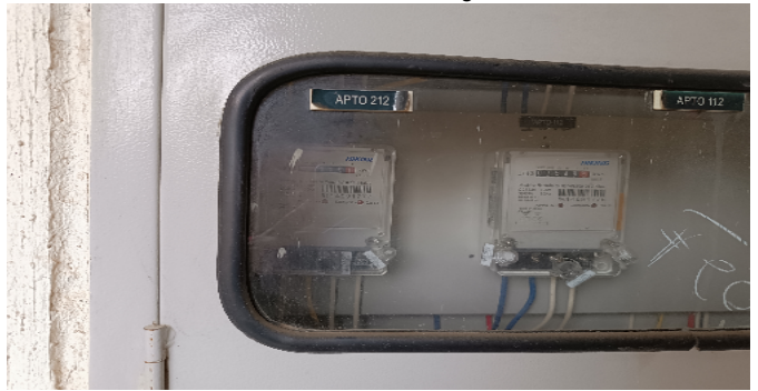
Contador de Energia
