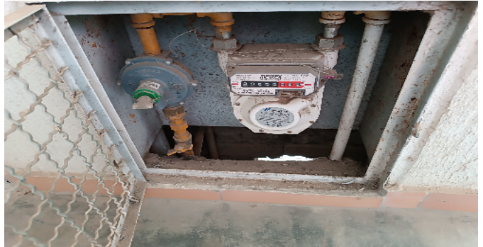
Contador de Gas
