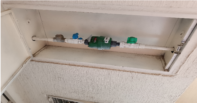
Contador de Agua
