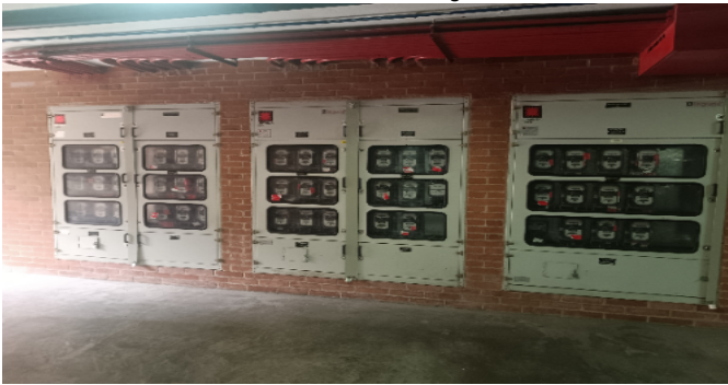
Contador de Energia
