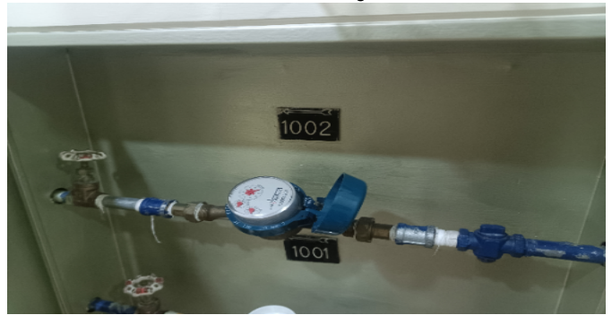
Contador de Agua
