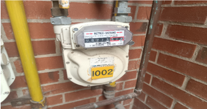
Contador de Gas
