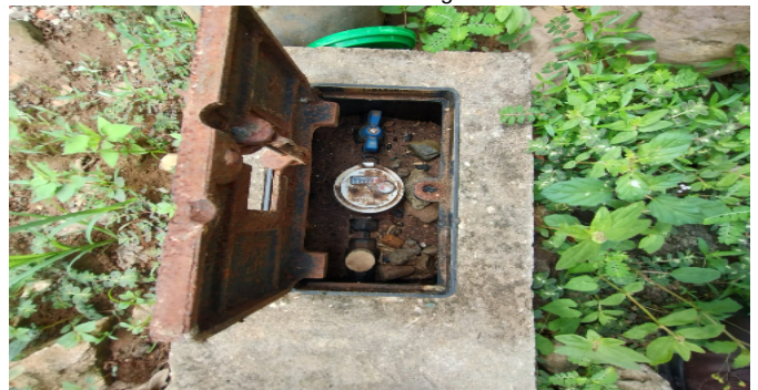
Contador de Agua
