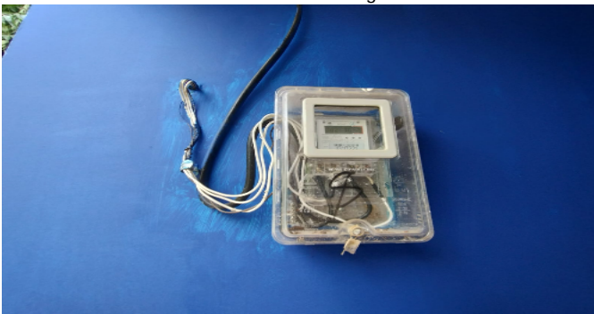
Contador de Energia
