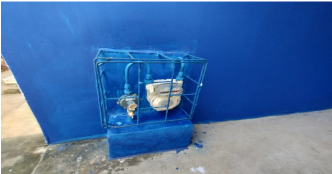
Contador de Gas
