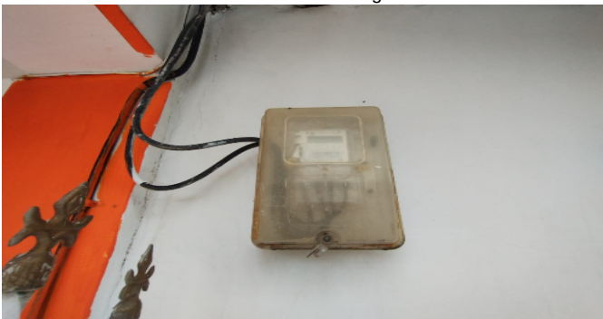
Contador de Energia
