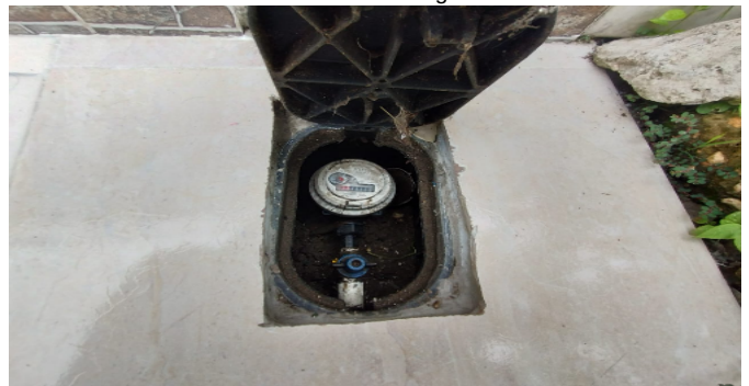
Contador de Agua
