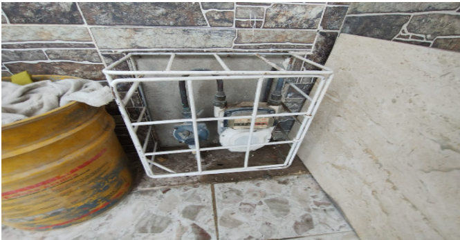
Contador de Gas
