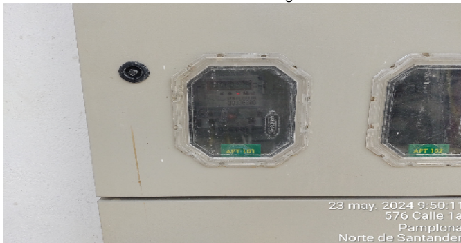
Contador de Energia
