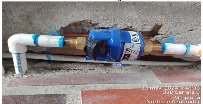
Contador de Agua
