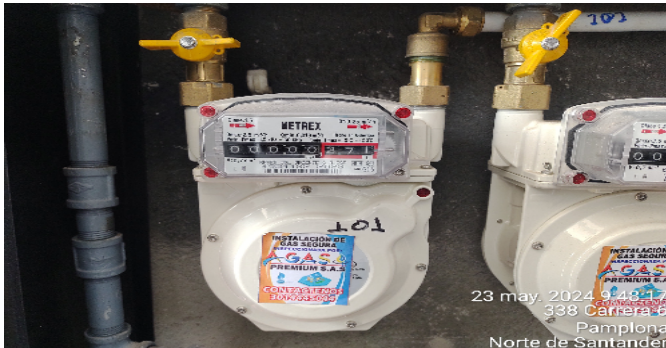
Contador de Gas
