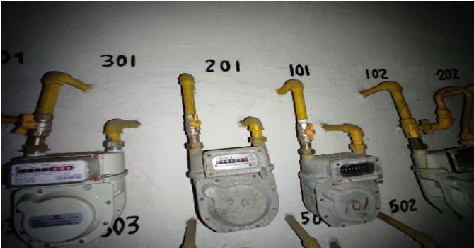
Contador de Gas
