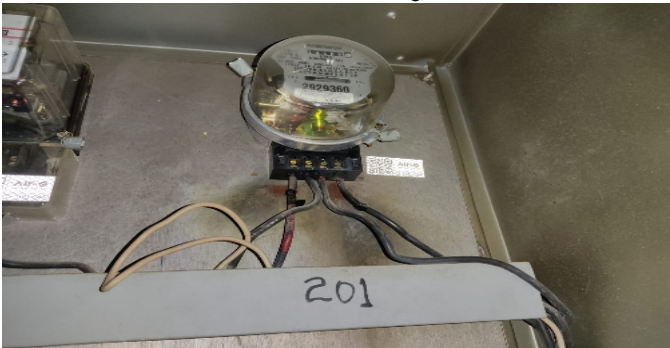
Contador de Energia
