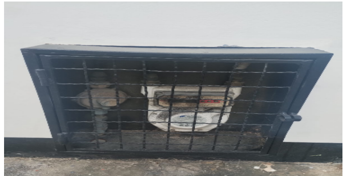
Contador de Gas
