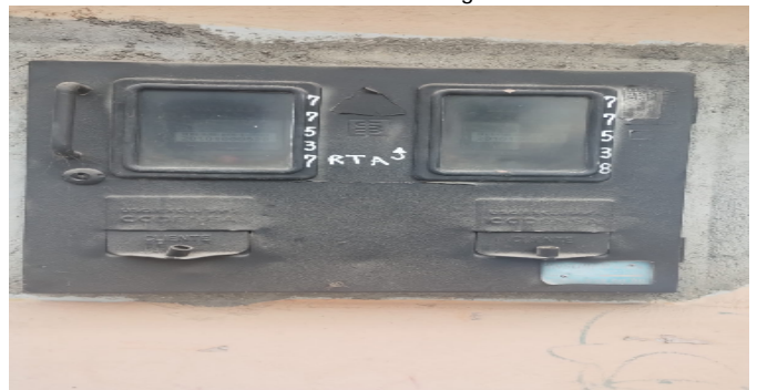
Contador de Energia
