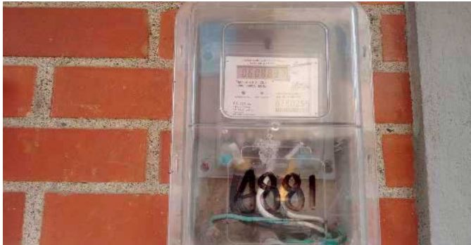
Contador de Energia
