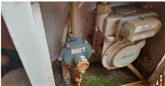
Contador de Gas
