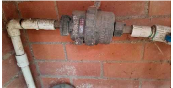
Contador de Agua
