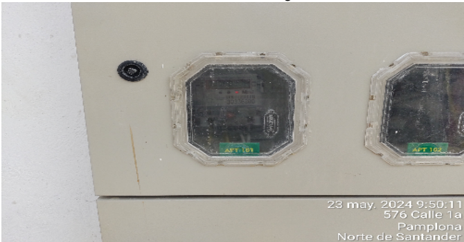
Contador de Energia
