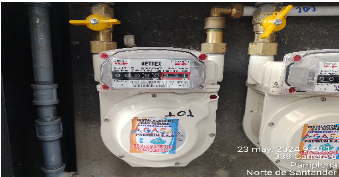
Contador de Gas
