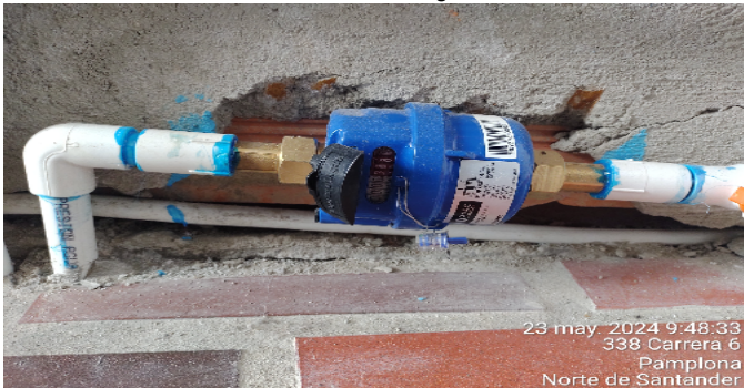
Contador de Agua
